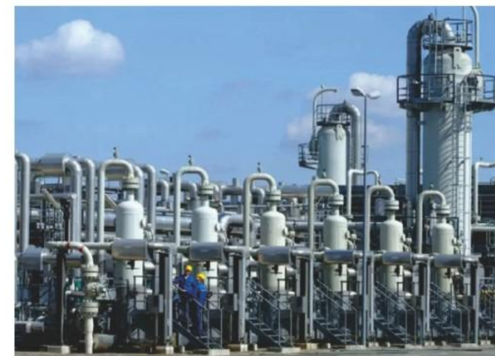
重庆龙冉能源科技有限公司100万方日天然气液化厂工程
